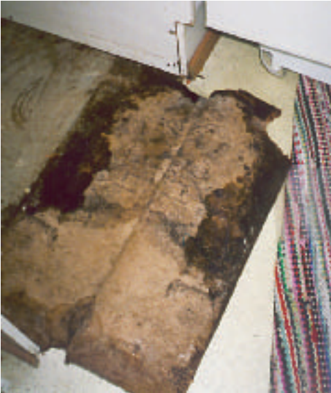
Kuva 4. Astianpesukoneen vuodosta aiheutunut keittiön muovimaton vaurio. Matosta lähti voimakas maakellarin haju.
