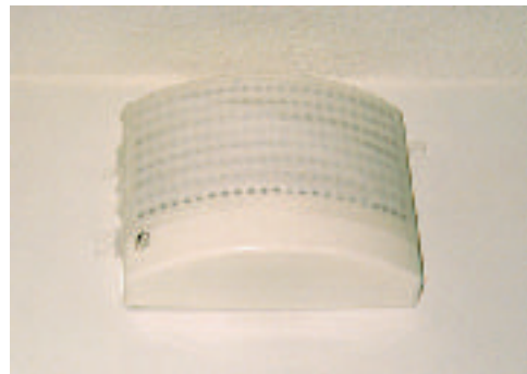
Kuva 3. Asukkaan teippaama koneellisen tulo- ja poistoilmavaihtojärjestelmän tuloilmaventtiili. Asukas koki ilmanvaihdon aiheuttavan nenä- ja silmäoireita.
