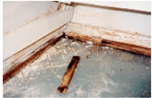
Kuva 8. Ulkoa rakenteisiin päässeen kosteuden aiheuttama vaurio toimistohuoneessa. Vaurio oli piilossa nojatuolin takana, ja se oli saanut rauhassa laajeta.
