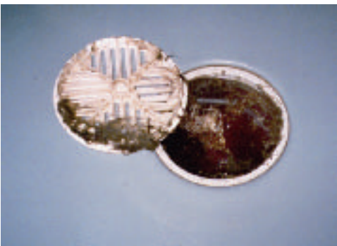
Kuva 6. Asukkaan mieltämä homeen haju kylpyhuoneessa osoittautuu usein likaisesta lattiakaivosta lähteväksi viemärin hajuksi.
