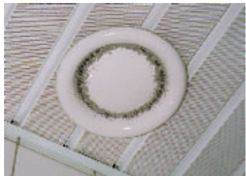
Kuva 7. Likainen poistoilmaventtiili. Sairaalan kirurgisen osaston potilaiden pesuhuoneessa ei ilma vaihtunut.
